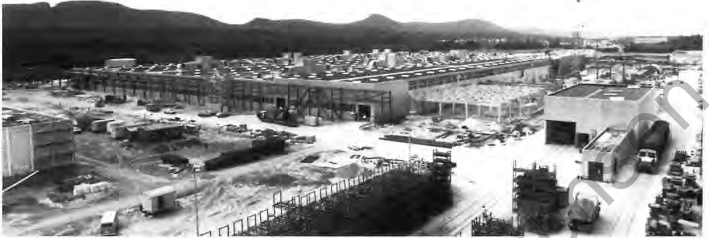
Das neue Motorenwerk in Kaiserslautern noch in der Bauphase; doch schon werden im Inneren Maschinen und Anlagen installiert. Der Bau ist 294 m lang und 181 m breit.
