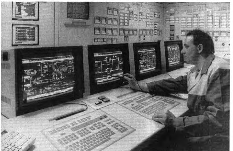
Warte: Hier laufen die Datenstränge des Kraftwerks zusammen
